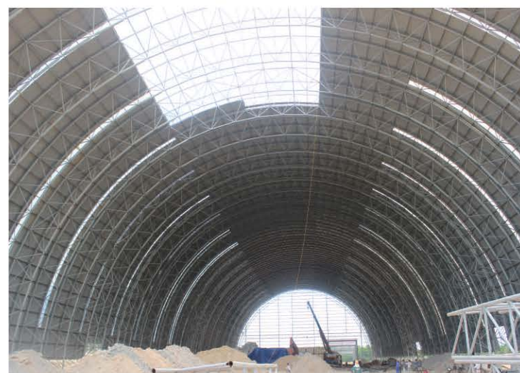
HỆ THỐNG KHO NHÀ MÁY XI MĂNG ĐỒNG LÂM
