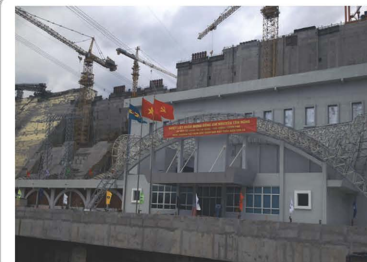
MÁI CHE TỔ MÁY NHÀ MÁY THỦY ĐIỆN SƠN LA
